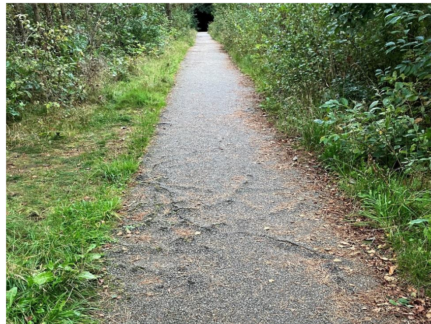
Træerødder som har ødelagt asfaltsti i Løvbakkerne, udgør forhindring for handicappede. Foto: Elsebeth Houe
